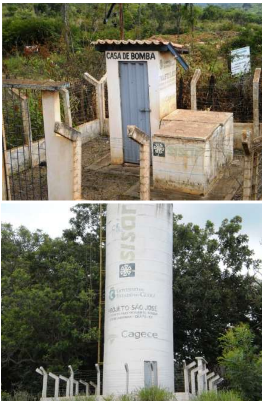
Figura 7.58 – Vista do poço tubular ( Q = 7,2 \text{ m}^3/\text{h} ) e REL de 28 \text{ m}^3 que fazem parte do sistema da localidade de Lagoinha, município do Crato, de responsabilidade do SISAR.
