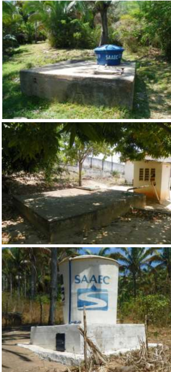
Figura 7.41 – Vista do fonte ( Q = 4,8 \text{ m}^3/\text{h} ), reservatório semienterrado RSE de 50 \text{ m}^3 e do REL de 10 \text{ m}^3 que fazem parte do sistema do distrito de Santa Fé, município do Crato, de responsabilidade da SAAEC.
