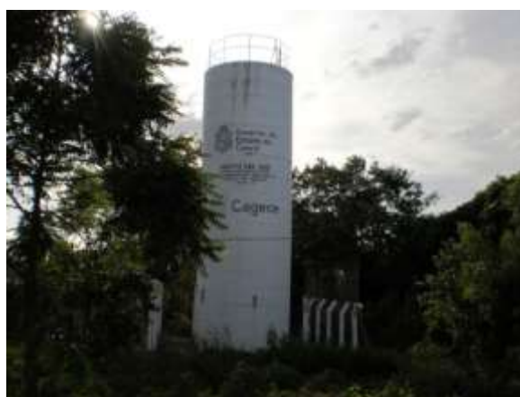
Figura 7.97 – Vista do poço tubular (Q desconhecido) e REL de 20 m 3 que fazem parte do sistema da localidade de Cachoeira dos Gonçalves, município do Crato, de responsabilidade do SISAR.
