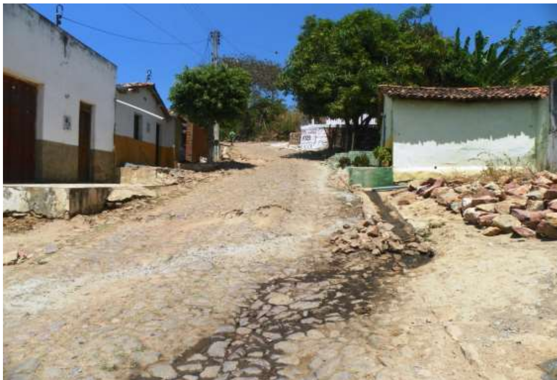
Figura 7.126 – Esgoto a céu aberto no distrito de Santa Fé – Rua Vicente Teles. Fonte: Consórcio DGH-Cariri (2012).
