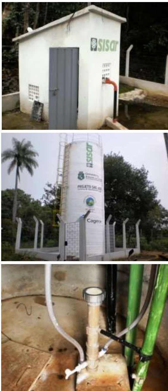
Figura 7.79 – Vista do poço tubular ( Q = 2,8 \text{ m}^3/\text{h} ) e REL de 25 \text{ m}^3 que fazem parte do sistema da localidade de Boa Vista, município do Crato, de responsabilidade do SISAR.
