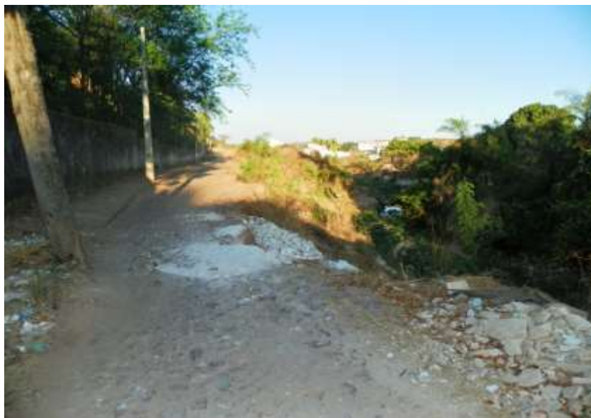
Figura 7.153 – Erosão e assoreamento do Canal do Granjeiro – Rua Manoel Almino de Lima.
