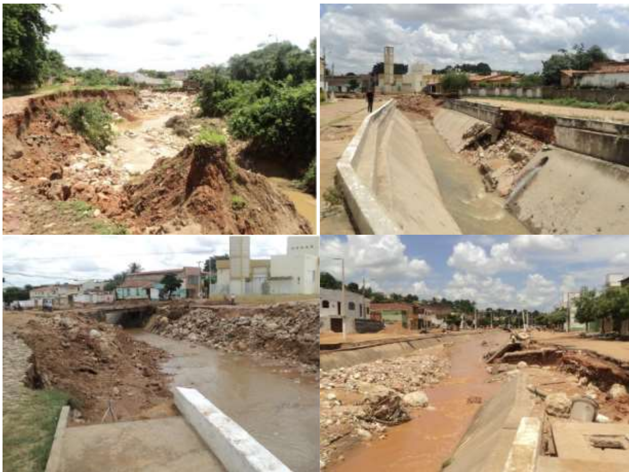
Figura 4.15 – Erosão na calha natural do rio Granjeiro e trechos canalizados mais afetados com a enxurrada de 2011.
