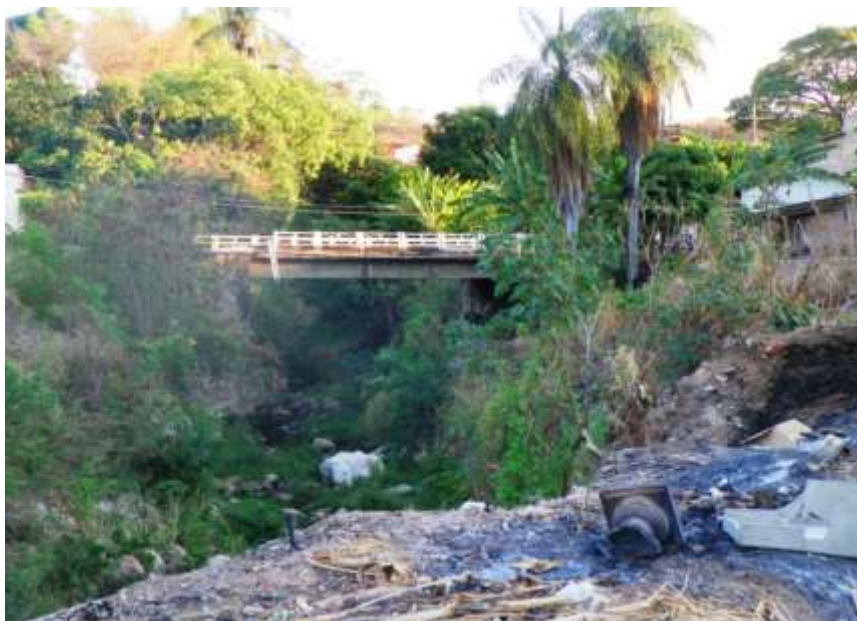
Figura 7.146 – Ponte sobre o rio Granjeiro – Rua Irineu Pinheiro, com destaque para a presença de lixo nas margens e na calha do referido rio.
