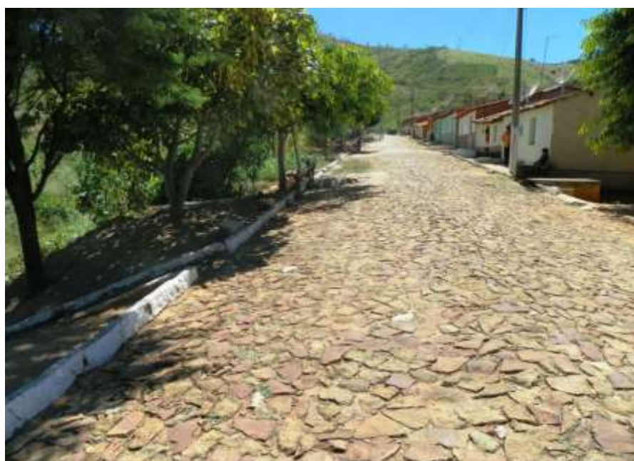
Figura 7.165 – Drenagem superficial na Rua Maria Amélia – Distrito de Dom Quintino. Fonte: Consórcio DGH-Cariri (2012).
