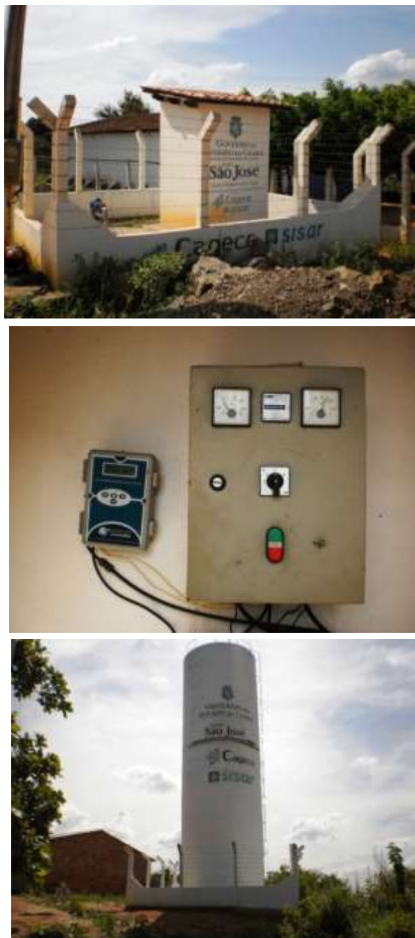
Figura 7.100 – Vista do poço tubular ( Q = 5,2 \text{ m}^3/\text{h} ) e REL de 28 \text{ m}^3 que fazem parte do sistema da localidade de Sítio Bréa, município do Crato, de responsabilidade do SISAR.
