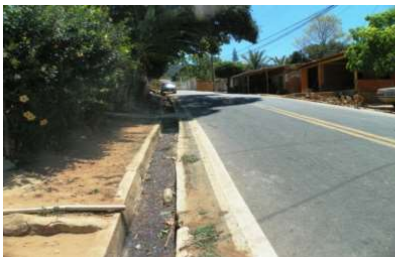
Figura 7.116 – Esgoto a céu aberto no distrito de Belmonte – Rua José Horácio Pequeno.
