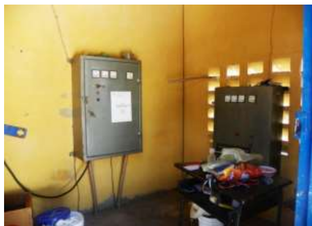
Figura 7.38 – Vista do poço amazonas (Q desconhecida), estação elevatória de água tratada (EEAT-01) e casa de comando que fazem parte do sistema do distrito de Ponta da Serra, município do Crato, de responsabilidade da SAAEC.
