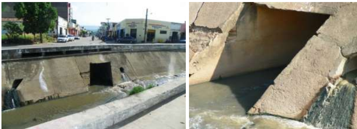
Figura 7.112 – Lançamento de esgoto a céu aberto que chegam ao canal do rio Granjeiro por meio de galerias, sede do Crato.
