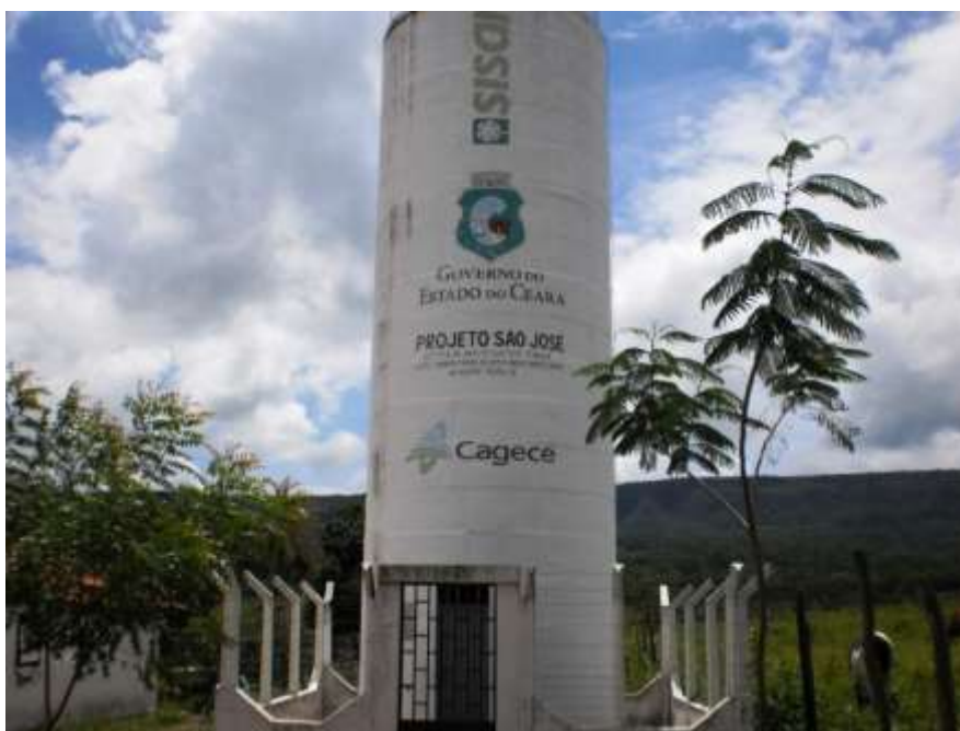
Figura 7.73 – Vista do poço tubular ( Q = 5,4 \text{ m}^3/\text{h} ) e REL de 20 \text{ m}^3 que fazem parte do sistema da localidade de Belo Horizonte, município do Crato, de responsabilidade do SISAR.
