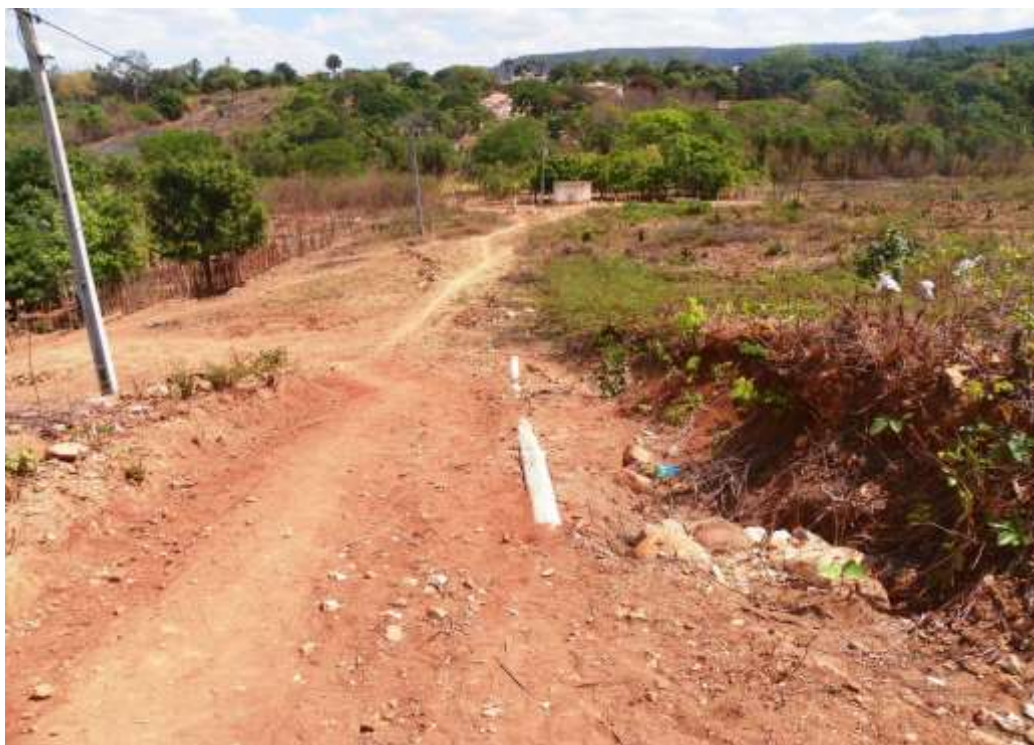
Figura 7.16 –Vista da adutora que liga o poço Sertãozinho ao reservatório apoiado RAP Sertãozinho de 1000 m 3 , na sede do Crato.
