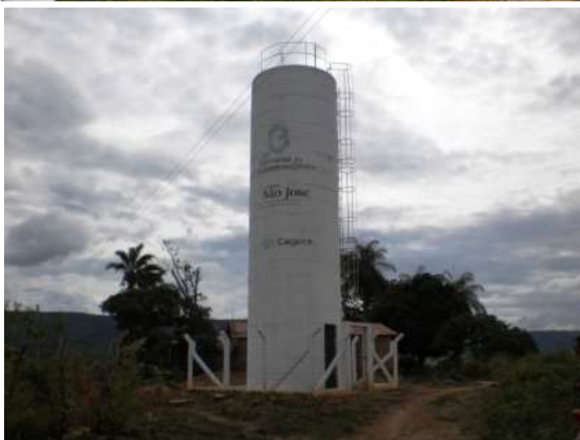
Figura 7.94 – Vista do poço tubular ( Q = 6,6 \text{ m}^3/\text{h} ) e REL de 28 \text{ m}^3 que fazem parte do sistema da localidade de Currais de Baixo, município do Crato, de responsabilidade do SISAR.
