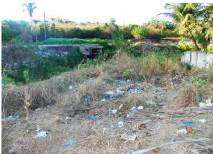
Figura 7.152 – Presença de lixo nas margens do Canal do Granjeiro – Rua Manoel Almino de Lima. Fonte: Consórcio DGH-Cariri (2012).
