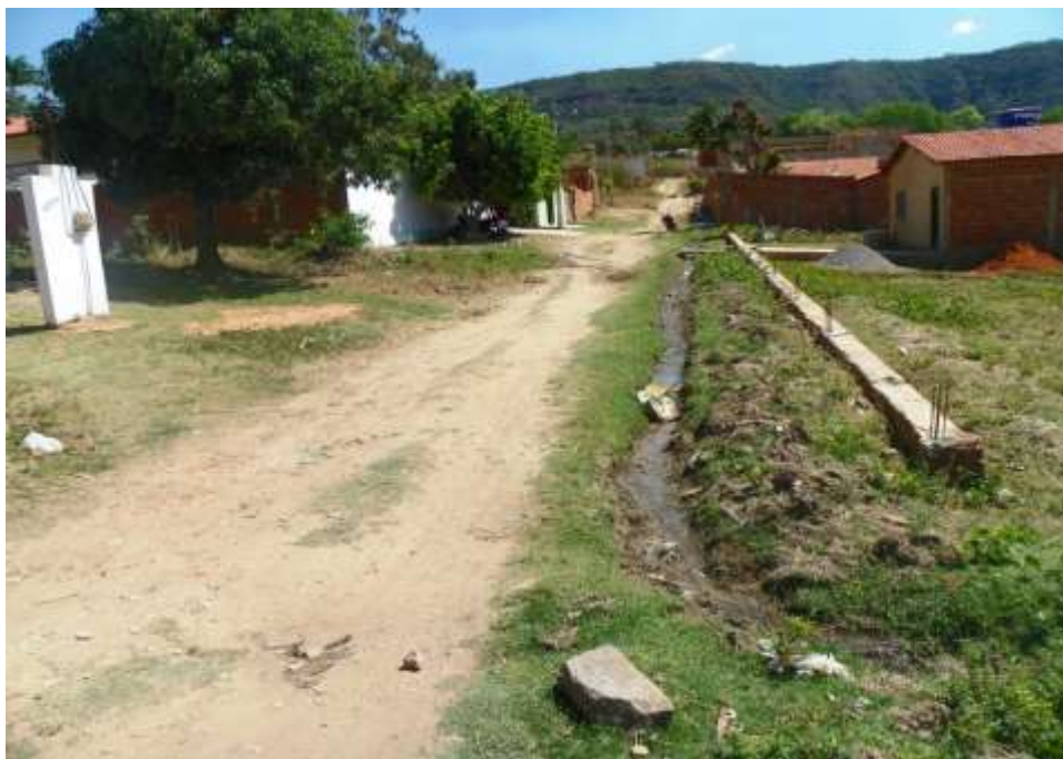
Figura 7.117 – Esgoto a céu aberto no distrito de Belmonte – Rua João Hélio. Fonte: Consórcio DGH-Cariri (2012).
