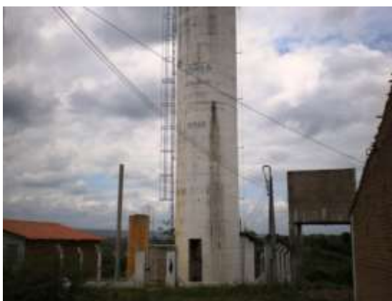
Figura 7.76 – Vista do poço tubular ( Q = 5,5 \text{ m}^3/\text{h} ) e REL de 30 \text{ m}^3 que fazem parte do sistema da localidade de Palmeirinha dos Vilar, município do Crato, de responsabilidade do SISAR.
