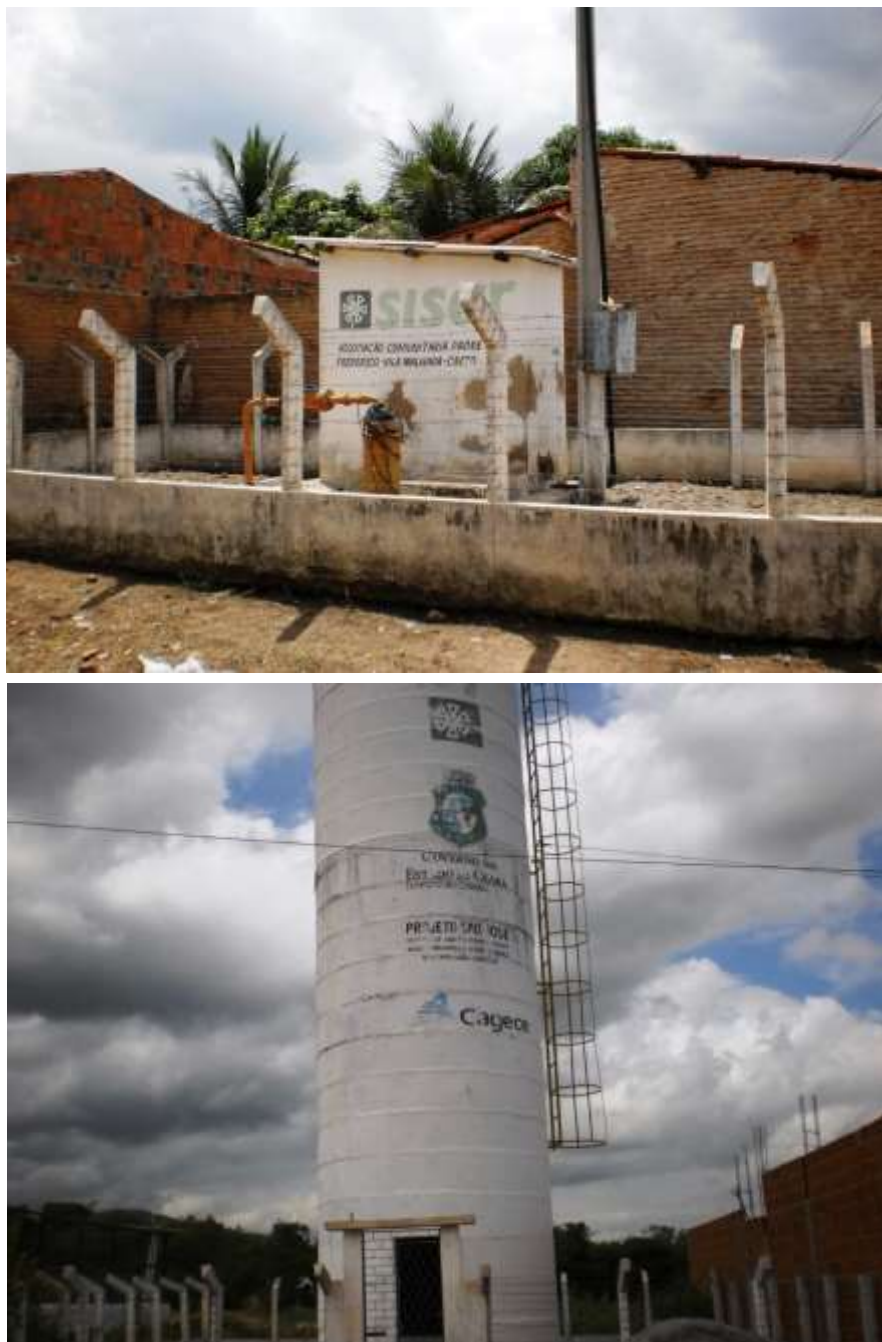
Figura 7.55 – Vista do poço tubular ( Q = 14,0 \text{ m}^3/\text{h} ) e REL de 30 \text{ m}^3 que fazem parte do sistema da localidade de Vila Malhada, município do Crato, de responsabilidade do SISAR.
