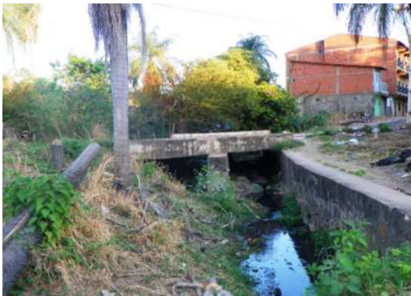
Figura 7.149 – Passagem molhada em péssimo estado de conservação, com risco de colapso – Rua Gal. Joaquim P. Monteiro.
