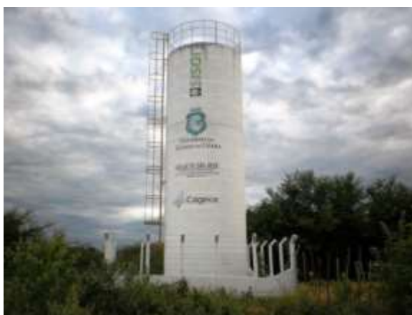
Figura 7.67 – Vista do poço tubular ( Q = 6,6 \text{ m}^3/\text{h} ) e REL de 20 \text{ m}^3 que fazem parte do sistema da localidade de Baixio Verde, município do Crato, de responsabilidade do SISAR.
