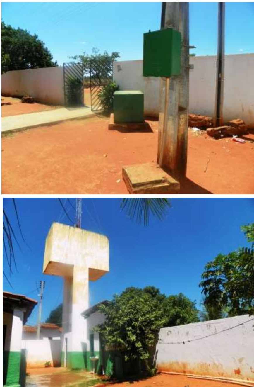
Figura 7.43 – Vista do poço tubular ( Q = 5,1 \text{ m}^3/\text{h} ) e do REL de 50 \text{ m}^3 que fazem parte do sistema do distrito de Santa Rosa, município do Crato, de responsabilidade da SAAEC.
