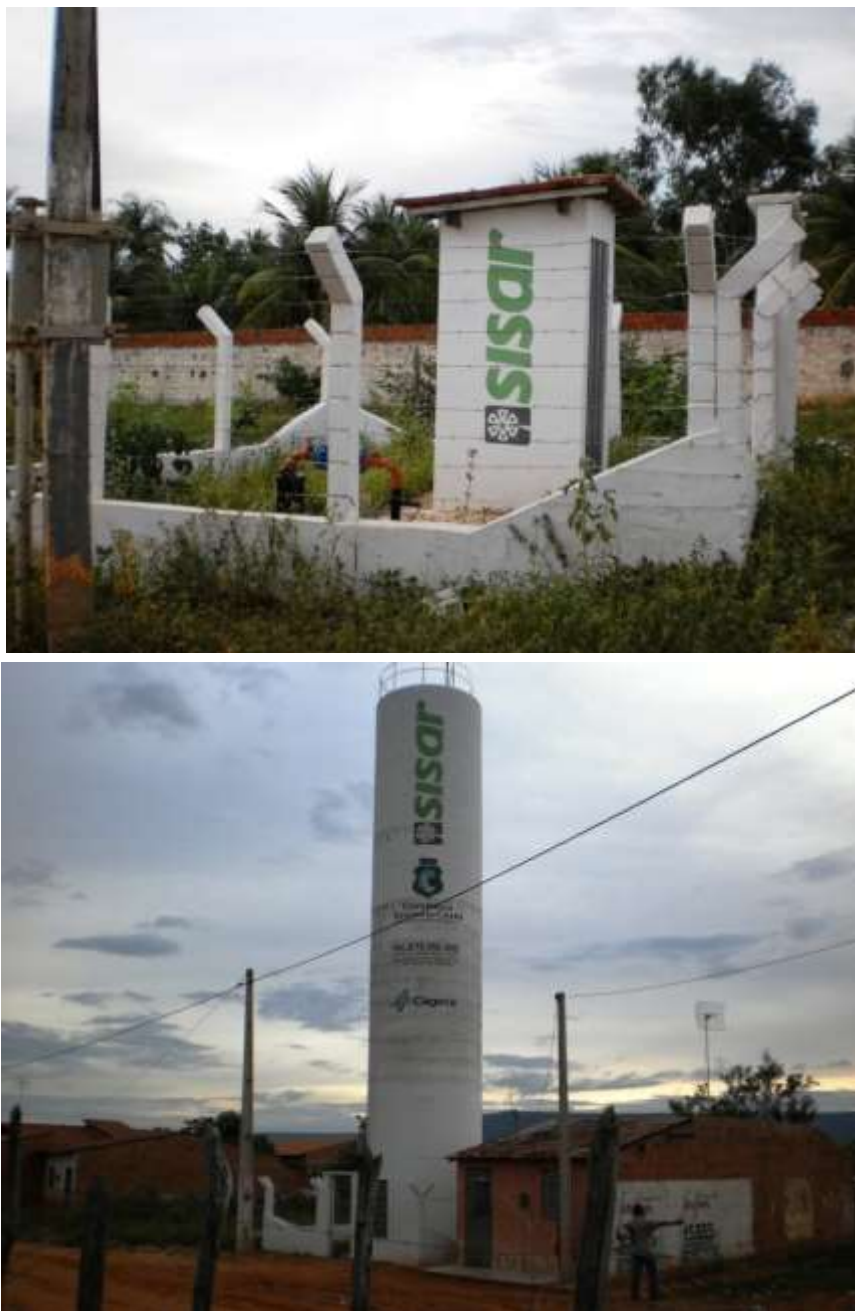
Figura 7.85 – Vista do poço tubular ( Q = 5,1 \text{ m}^3/\text{h} ) e REL de 30 \text{ m}^3 que fazem parte do sistema da localidade de Baixio dos Robertos, município do Crato, de responsabilidade do SISAR.
