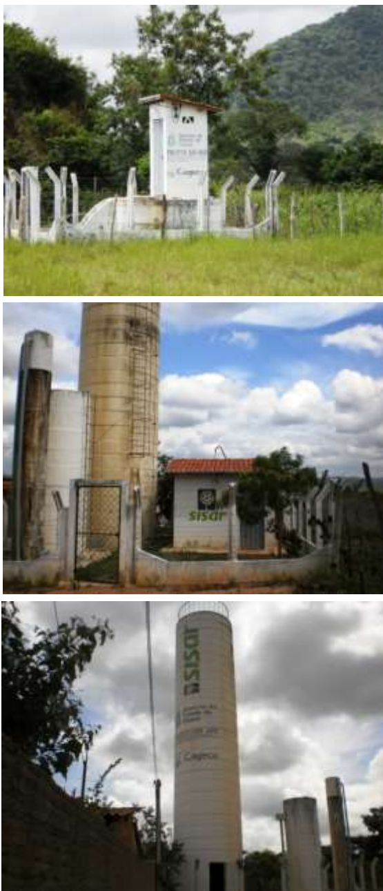
Figura 7.64 – Vista do poço tubular ( Q = 6,0 \text{ m}^3/\text{h} ) e REL de 35 \text{ m}^3 que fazem parte do sistema da localidade de Palmeirinha dos Britos, município do Crato, de responsabilidade do SISAR.
