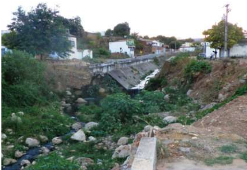
Figura 7.155 – Final do Canal do Granjeiro – Rua Manoel Almino de Lima/Av. José Alves de Figueiredo, com destaque para a existência de processos erosivos.
