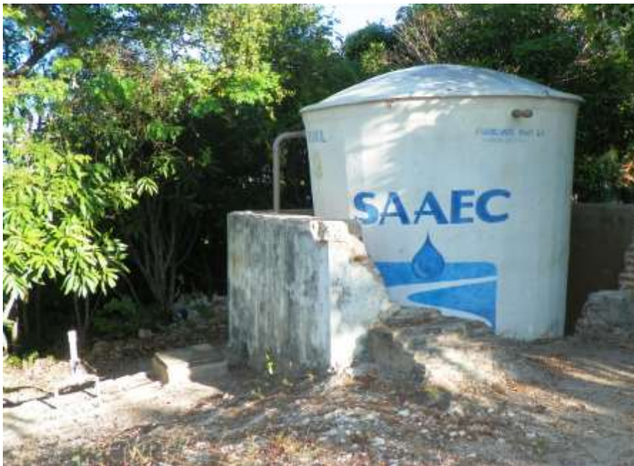
Figura 7.29 – Vista da fonte (Q desconhecida) e do RAP de 10 m 3 que fazem parte do sistema do distrito de Campo Alegre, município do Crato, de responsabilidade da SAAEC.
