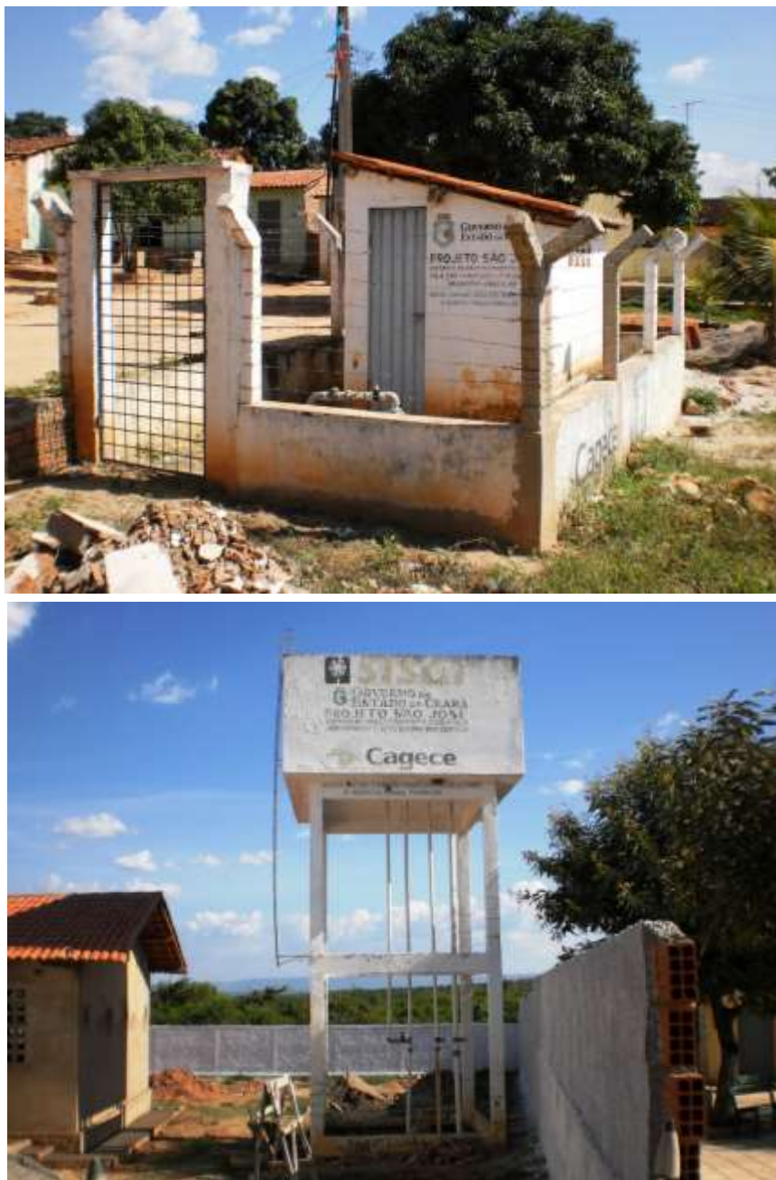
Figura 7.88 – Vista do poço tubular ( Q = 5,8 \text{ m}^3/\text{h} ) e REL de 35 \text{ m}^3 que fazem parte do sistema da localidade de Vila São Francisco, município do Crato, de responsabilidade do SISAR.
