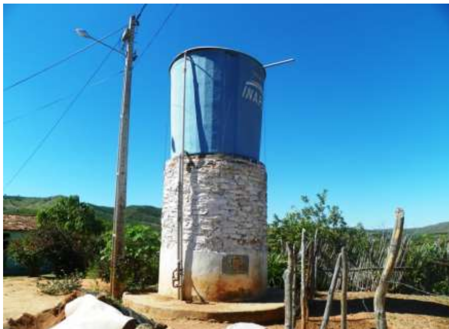
Figura 7.32 – Vista do poço artesiano PA-02 e do reservatório elevado REL-03 de 10 m 3 que fazem parte do sistema do distrito de Dom Quintino, município do Crato, de responsabilidade da SAAEC.
