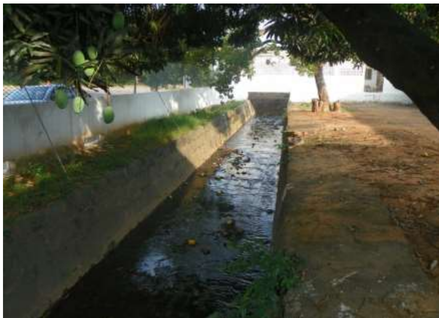
Figura 7.147 – Canal do Granjeiro – Rua Sucupira.
