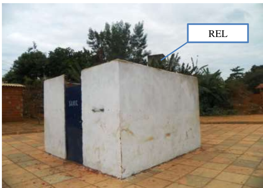
Figura 7.12 – Vista do poço Vila Alta 1 e Vila Lobo que fazem parte do manancial da sede do Crato.
