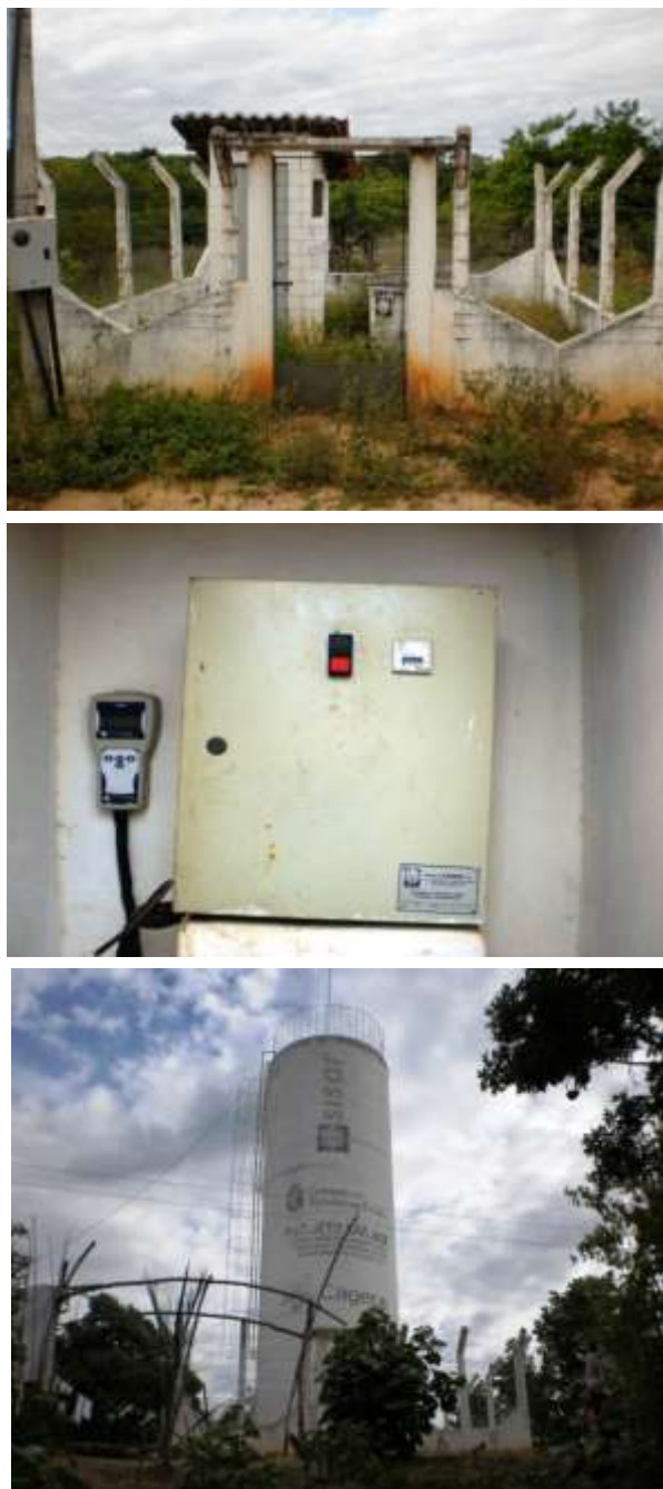
Figura 7.61 – Vista do poço tubular ( Q = 6,4 \text{ m}^3/\text{h} ) e REL de 25 \text{ m}^3 que fazem parte do sistema da localidade de Sítio Alegre, município do Crato, de responsabilidade do SISAR.
