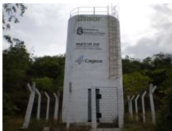
Figura 7.46 – Vista do poço tubular ( Q = 8,3 \text{ m}^3/\text{h} ) e REL de 30 \text{ m}^3 que fazem parte do sistema do distrito de Baixio das Palmeiras, município do Crato, de responsabilidade do SISAR.
