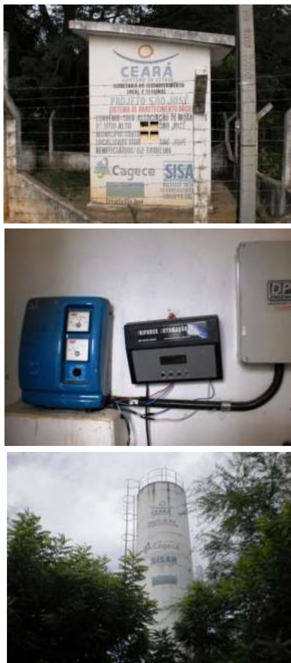
Figura 7.70 – Vista do poço tubular ( Q = 6,2 \text{ m}^3/\text{h} ) e REL de 25 \text{ m}^3 que fazem parte do sistema da localidade de São José, município do Crato, de responsabilidade do SISAR.
