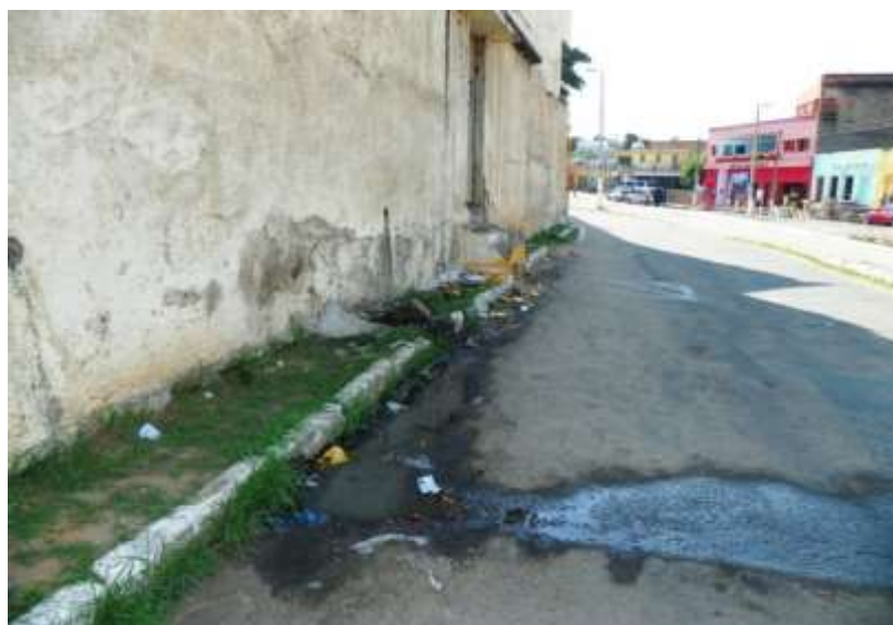
Figura 7.111 – Extravasamento no poço de visita localizado na Avenida José Alves de Figueiredo – Centro, sede do Crato.
