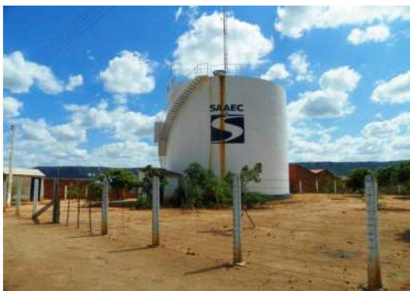
Figura 7.18 – Vista do Reservatório RAP Sertãozinho (1000m 3 ), responsável pela distribuição de água para sede do Crato.
