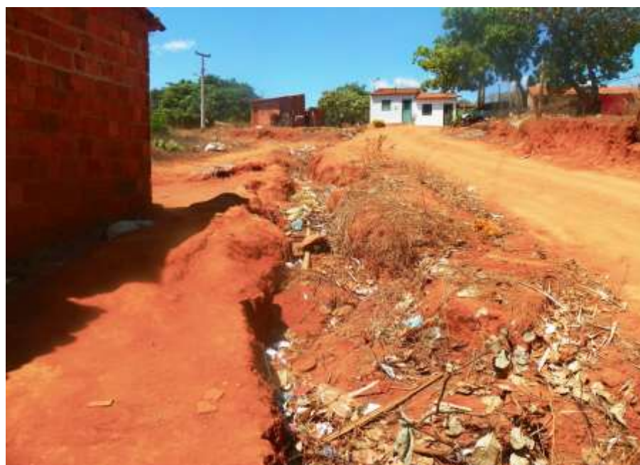
Figura 7.173 – Erosão de via e formação de voçoroca – Distrito de Santa Rosa.
